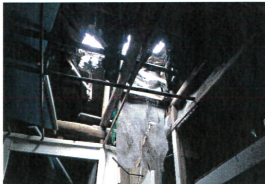
4. 國校路 65 巷 11 號-屋頂坍塌
