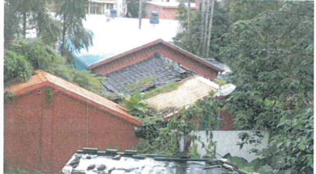
2. 國校路 65 巷 19 號-屋頂坍塌
